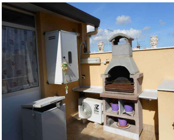
33. Piano 3°, Terrazza. A sinistra la veranda, al centro la caldaia a gas, a destra il barbecue
